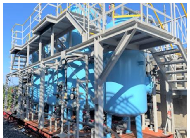
<再稼働した中型活性炭塔>
